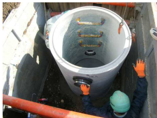
写真-6 硫酸環境での使用例（マンホール）
